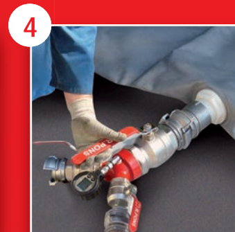
4 Ouvrir la vanne DN65 et fermer les 2 vannes DN45 du collecteur
